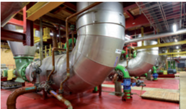
Blick in die neue KKF-Anlage: der Bereich der Umwälzpumpen der Zwangsumlaufverdampfer, die die Lösung zu den außenliegenden Wärmetauschern fördern.
